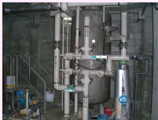
地下水浄水装置 [町田東急ツインズ]
